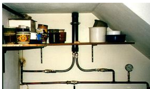
Installation après le compteur
